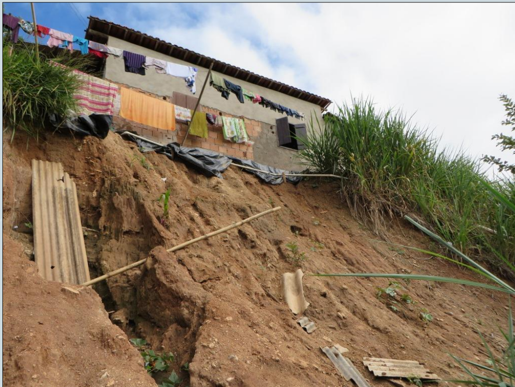
Erosão em aterro lançado, São Pedro do Suaçuí – MG. Créditos: Júlio Lana, CPRM/SBG
