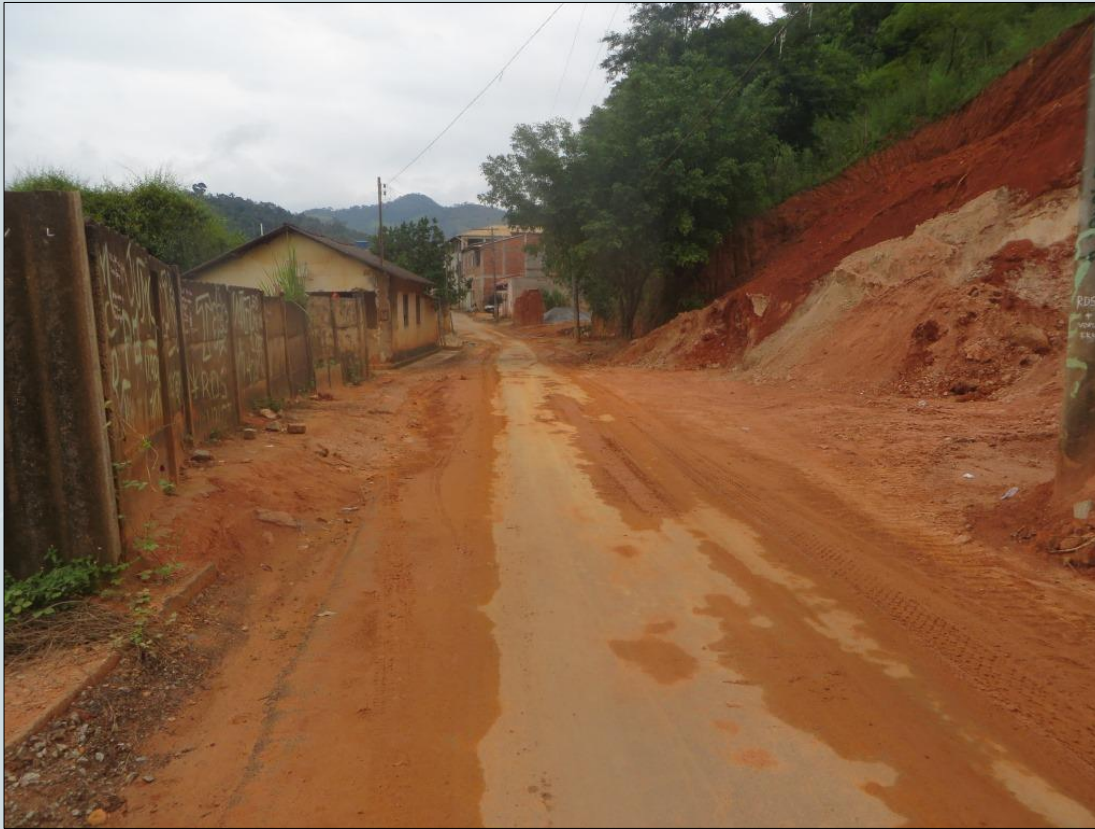
Material erodido dos cortes acumulados nas vias, Antônio Dias – MG. Créditos: Rafael Araújo, CPRM/SBG
