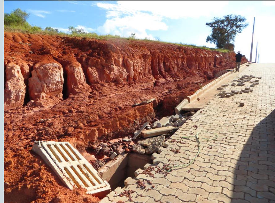
Erosão em via pavimentada, Ouro Preto – MG. Créditos: Júlio Lana, CPRM/SBG
