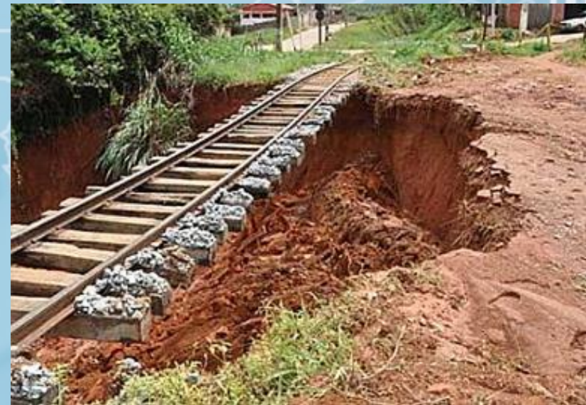
Deslizamento em aterro de ferrovia Local: Lavras-MG Créditos: O Lavrense
