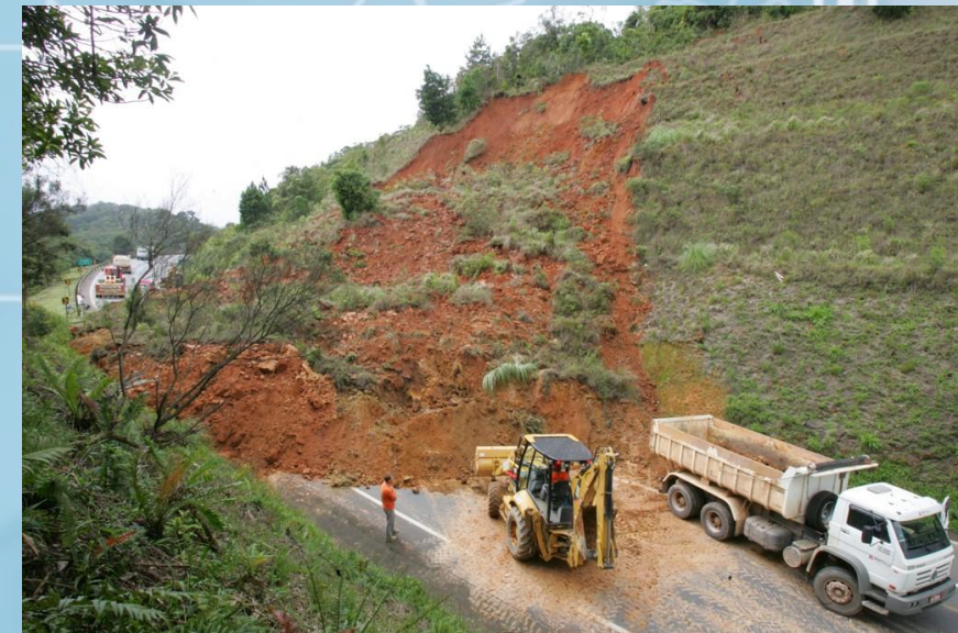
Deslizamento em talude de corte de rodovia Local: Rodovia BR-376, PR Créditos: Gazeta do Povo
