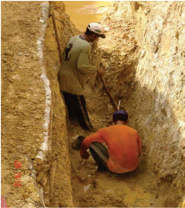
Foto 160 - Extração do minério de alto teor em rocha alterada com auxílio de picareta.
