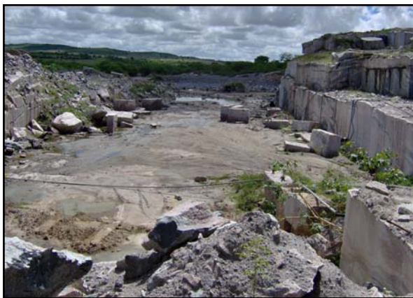
Foto 8.10: Vista de sul para norte da cava da Pedreira da Mineração Ferreira Costa, no estágio atual de exploração.
