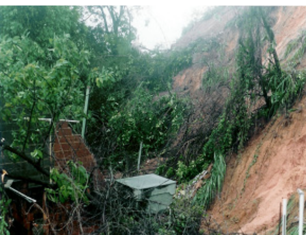
Figuras 8.10 e 8.11 - Detalhe da crista e dos danos associados ao deslizamento de solo no talude remanescente da atividade de saibreira em Magé, baixada fluminense
